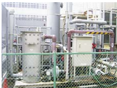
本社事業所の地下水浄化装置
