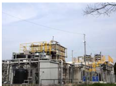
掛川工場の廃水処理施設
