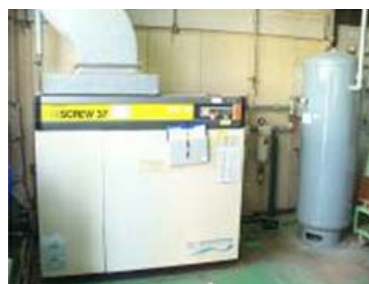
圧力の適正化を行ったコンプレッサー
