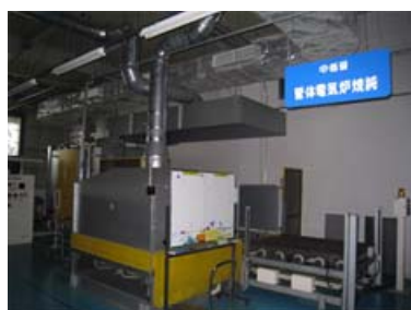
更新した電気焼鈍炉
